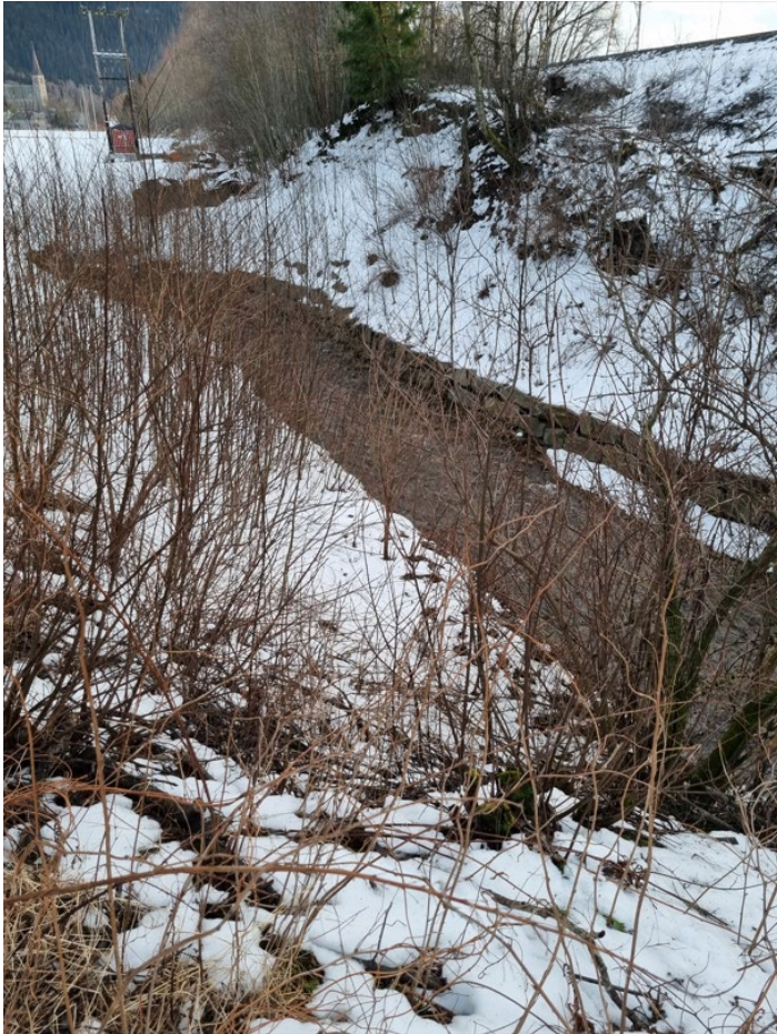
Figur 8-Lodbekken oppstrøms kulvert, område for fangrist
